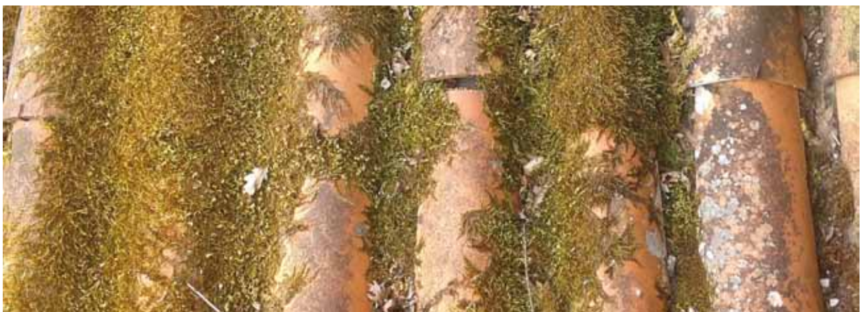
La cubierta de la iglesia se encuentra en muy mal estado
