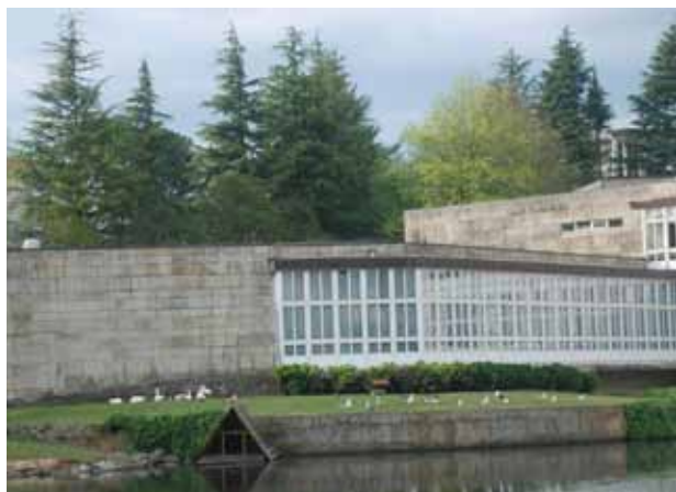
Las galerías del edificio presentan problemas de impermeabilidad
