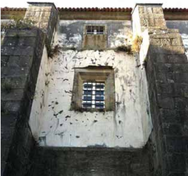
La iglesia estaba muy afectada por la humedad
