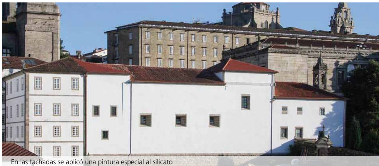
Las fachadas sur y oeste de la iglesia carecían de canalones
